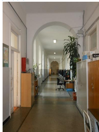
Figura 4.13 - Particolare dei corpi illuminanti ubicati nel corridoio
