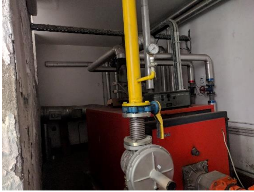
Figura 4.9 - Particolare della caldaia
